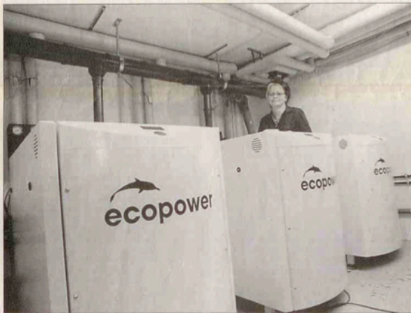
Claudia Fichter mit Kleinkraftwerken im Keller des Hotels Bürkle in Schmiden. Foto: Patricia Sigerist
